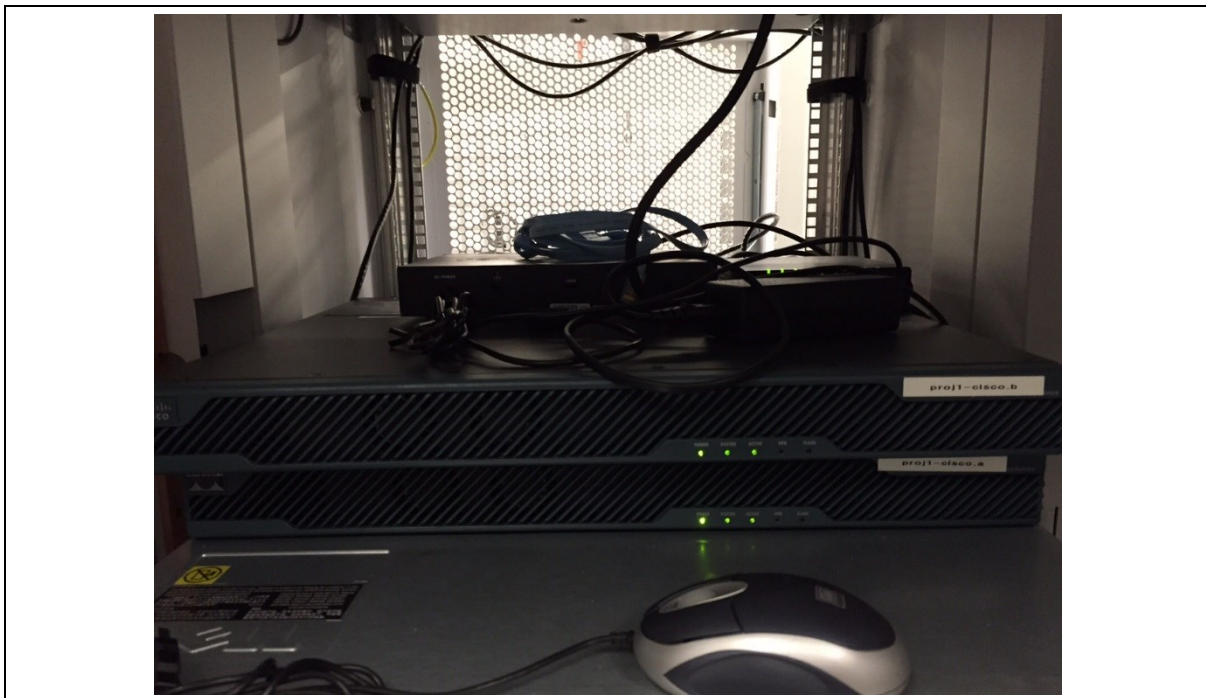
Figura 11 – Arquivo de imagem “image13.jpeg”, encontrado na pasta “\00-DATA\Evidence_Container_SafeHost_SA\00-Pictures_Rack_SafeHost \Bilder_Sari\Small_Rack_SafeHost” do Disco 07, mostrando os equipamentos dispostos no denominado “Half Size Rack”.
