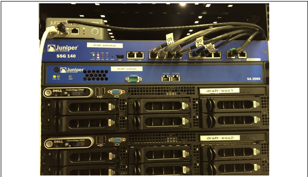
Figura 7 – Arquivo de imagem “image9.jpeg”, encontrado na pasta “\00-DATA\Evidence_Container_SafeHost_SA\00-Pictures_Rack_SafeHost \Bilder_Sari\Big_Rack_SafeHost”, do Disco 07, mostrando os equipamentos dispostos no denominado “Full Size Rack”.
