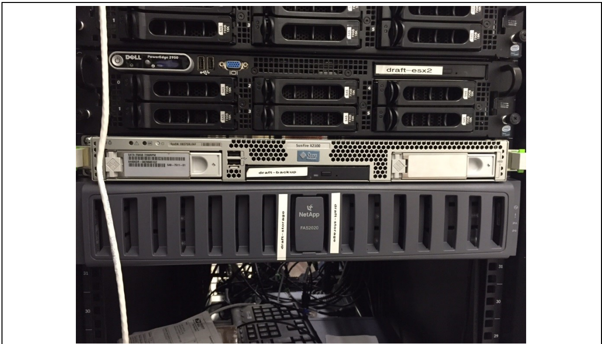
Figura 8 – Arquivo de imagem “image10.jpeg”, encontrado na pasta “\00-DATA\Evidence_Container_SafeHost_SA\00-Pictures_Rack_SafeHost \Bilder_Sari\Big_Rack_SafeHost”, do Disco 07, mostrando os equipamentos dispostos no denominado “Full Size Rack”.
